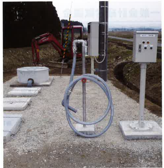
上蛸井地下水ポンプ
