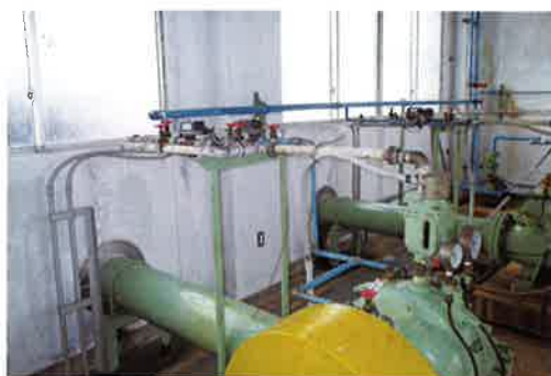
標揚水機場ポンプ
